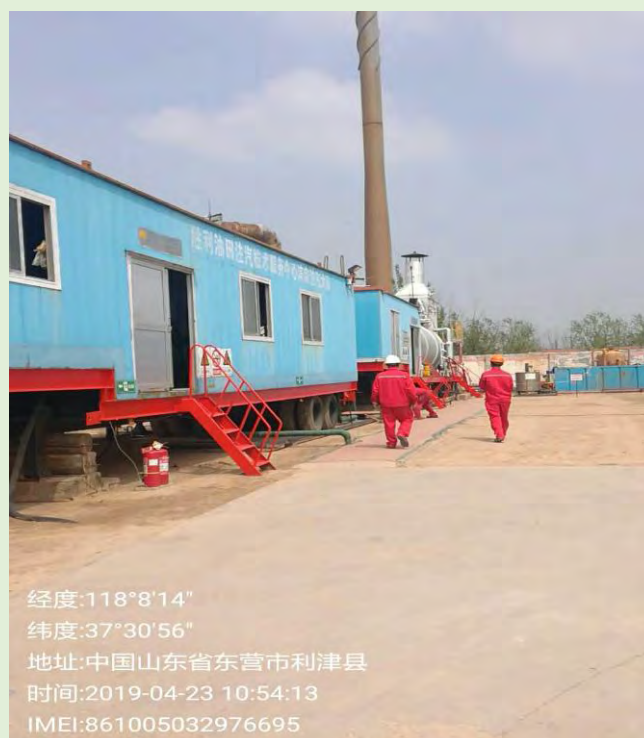
图 5-4 30t/h 注汽锅炉
